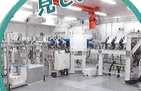
RI棟:サイクロトロン室
